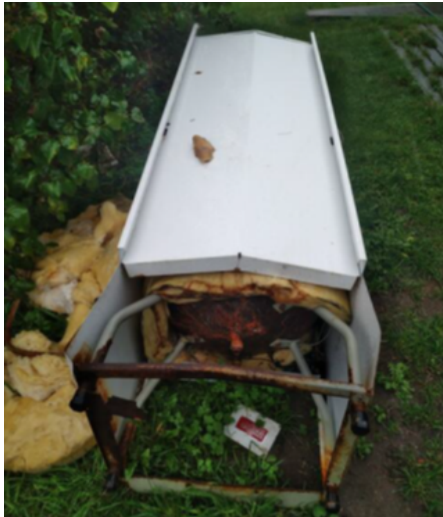
Bild på läckande vattenberedare efter att den blivit utlyft ur lokalen.
